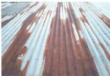
Foto 1: Cambio de techado laminas en mal estado y estructura metalica
